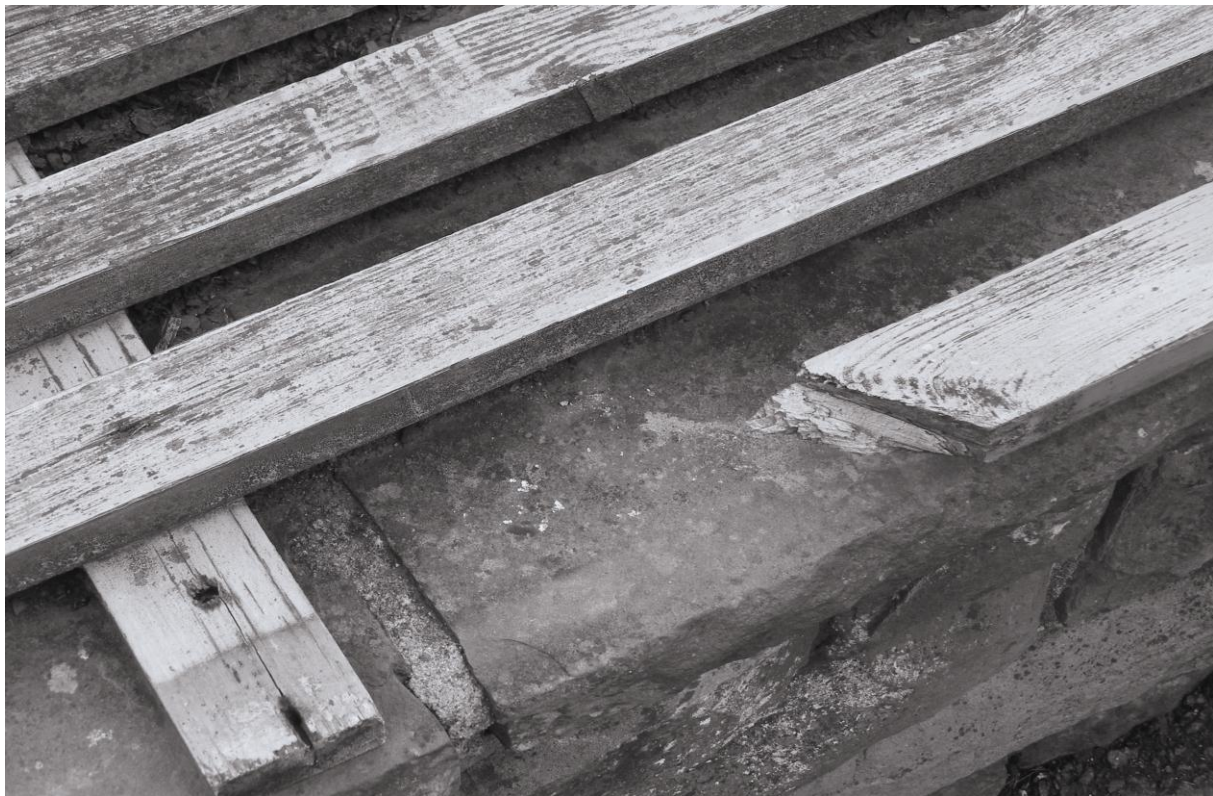
Hier wurden Bretter mutwillig abgebrochen und zerstört.
